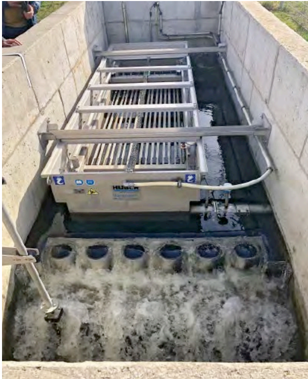
Abbildung 5.2.4-1: Beispiel eines installierten Wärmeübertrages im Vorfluter (Quelle: dwa.de/KA )
