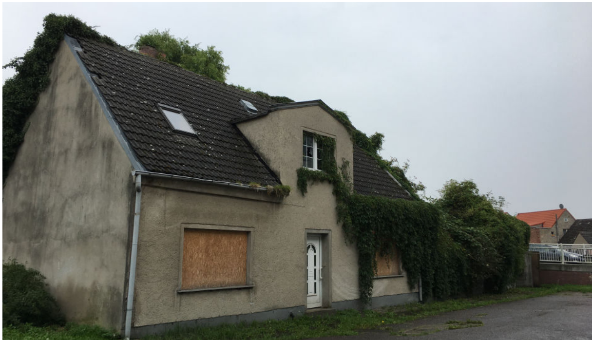
Franzstraße 2 – privates Einfamilienhaus, das schon seit Jahren leer steht, die Rückseite ist schon komplett zugewachsen.
